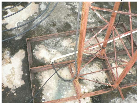
รูปภาพที่ ๑๓ ภาพเสาสายส่งสายอากาศและระบบสายตัวนำลงดิน วิทยุรับส่งของ รพ. หนองสูง
